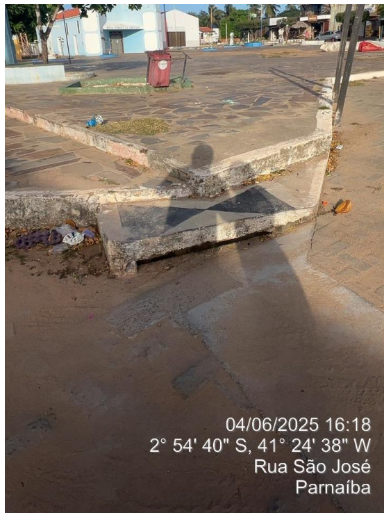
Figura 13 – Boca de Lobo – Praça central de Barra Grande.
