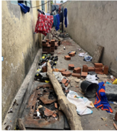
Figura 21 - Entulho acumulado Casa de Acolhimen- to Ka-Ubanoko Piratinga (1)
