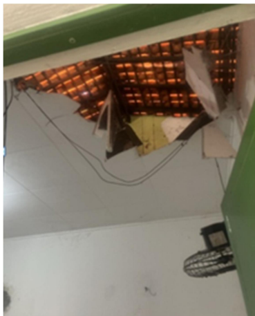
Figura 5 - Teto danificado Casa de Acolhimento Ka-Ubanoko- Miguel Rosa
