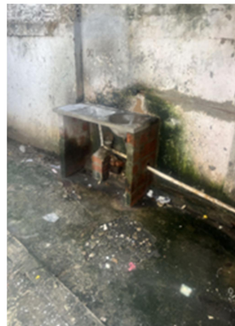
Figura 6 - Pia danificada na Casa de Acolhimento Ka-Ubanoko- Miguel Rosa
