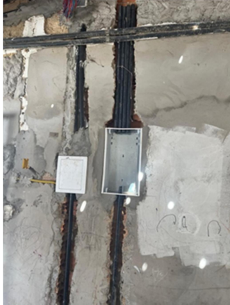
Figura 23 - Instalações elétricas expostas na Casa de Passagem
