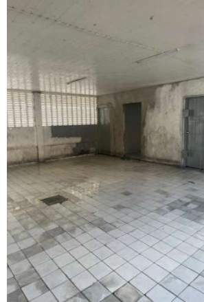
Figura 24 - Paredes com reboco incompleto, infiltrações e conservação precária
