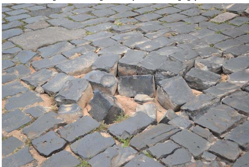
Figura 17 – Patologias em Calçamento – Desagregação.
