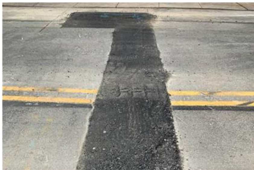
Figura 21 – Patologias em Pavimentação Asfáltica do tipo remendo.
