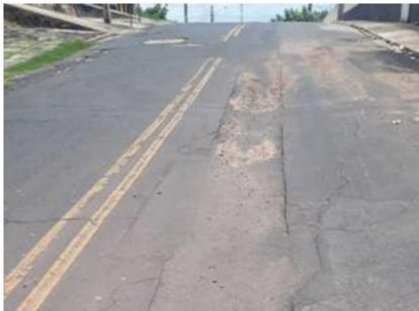
Figura 25 – Afundamento de vala, Rua Des. Mota, bairro Monte Castelo.
