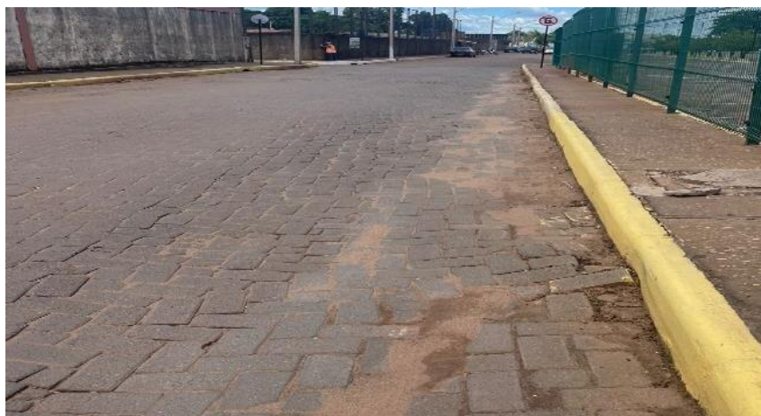
Figura 18 – Patologias em Pavimentação Intertravado do tipo deslocamento e desnível das peças.
