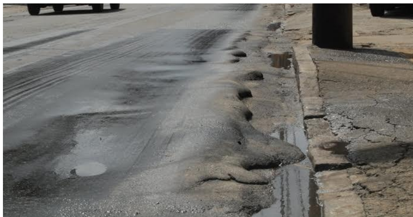
Figura 19 – Patologias em Pavimentação Asfáltica do tipo afundamento em trilha de roda.
