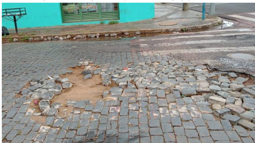
Figura 16 – Patologias em Calçamento – Desagregação/Panela.
