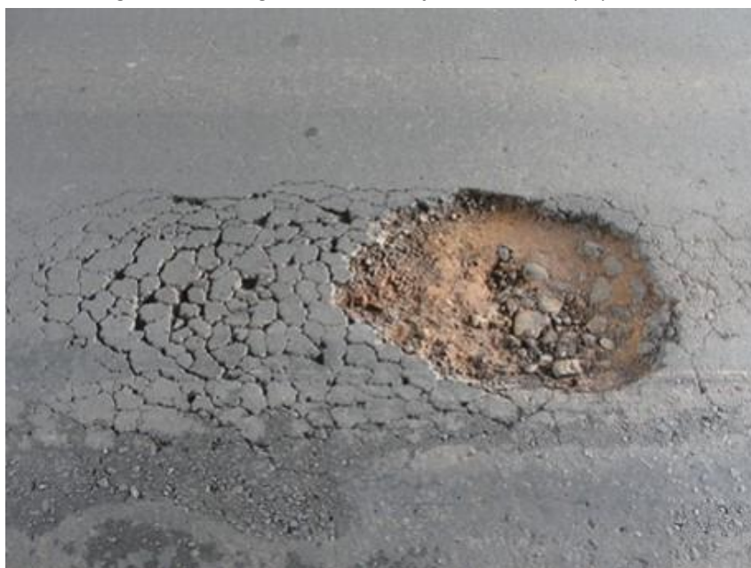
Figura 20 – Patologias em Pavimentação Asfáltica do tipo panela.
