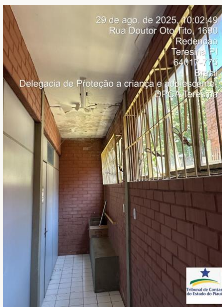
Figura 10 - Corredor de espera dos agendamentos: teto necessitando de reparos
