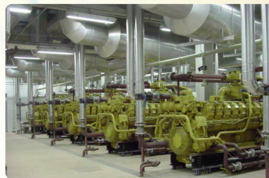
Moto-geradores usados no aproveitamento energético de biogás do Aterro Sanitário de Bandeirantes, São Paulo, SP
