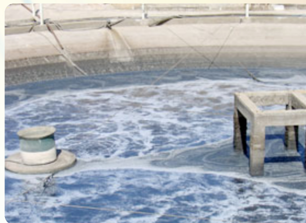
Tanque de equalização de esgoto
