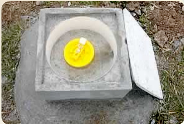
Vista superior da caixa de inspeção do poço de monitoramento de águas subterrâneas
