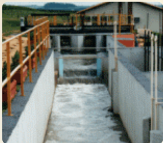
Calha de gradeamento de esgoto
