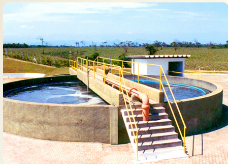
Sistema de lodo ativado de tratamento de chorume
