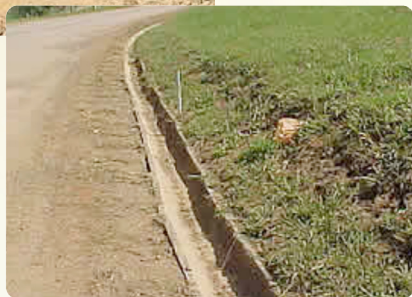
Sarjeta de drenagem definitiva de águas pluviais Fonte: SANTEC (2008)
