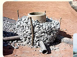
Dreno Chorume/Gases Fonte: PMJ (2008)
