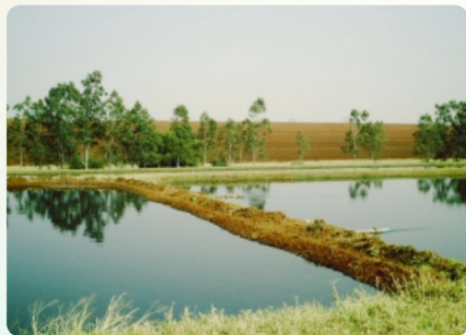
Lagoa aeróbia de estabilização de chorume
