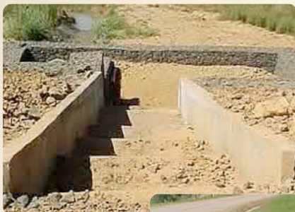
Descida de água de drenagem definitiva de águas pluviais Fonte: SANTEC (2008)
